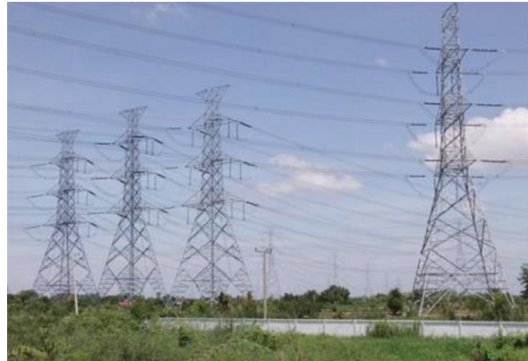
เสาไฟฟ้า
