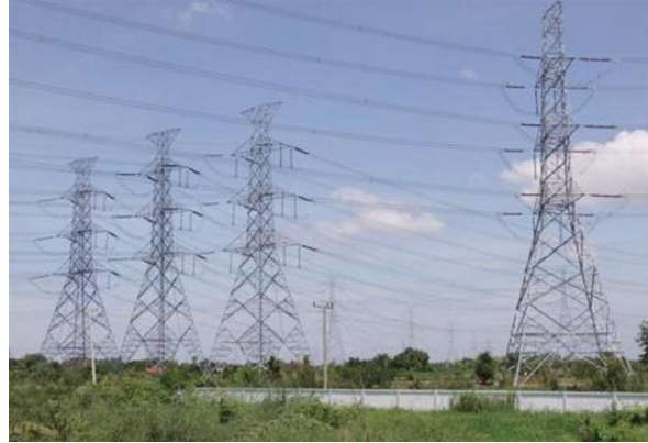
เสาไฟฟ้า
