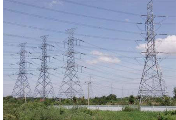
เสาไฟฟ้า
